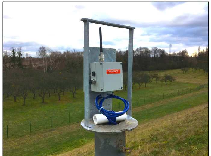
Obr.2 - Jednokanálový datalogger pro strunové snímače nainstalovaný na zhlaví vrtu
